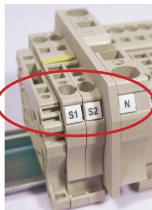
Figura 8: Terminales de conexión del transformador de corriente (TC).
